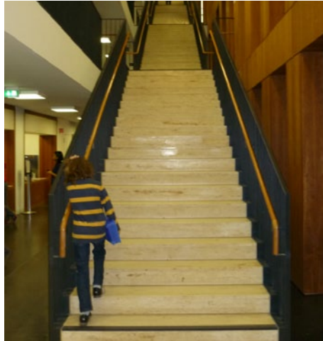
Abb. 7: Nachträgliche Stufenvorderkantenmarkierung durch Stahlblech, Jacob und Wilhelm Grimm Zentrum, Berlin, Max Dudler Architekt.
