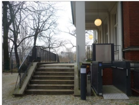
Abb. 3: Hubplattform im Außenbereich, Museum Charlottenburg Wilmersdorf, Berlin, Architekturbüro Pitz und Hoh.
